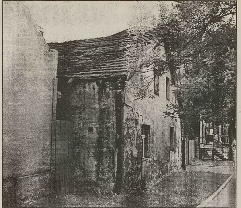
Na ul. Bożogrobców w Chorzowie Starym niszczy jeden z zabytkowych budynków... Foto: Piotr Rębacz
