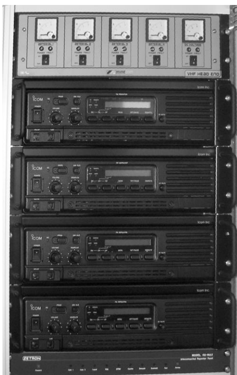
Rys. 5.32. Widok stacji bazowej systemu MCA 1000. Widoczne są: cztery przemienniki firmy ICOM, głowica (na górze), interfejs 48-MAX firmy ZETRON (na spodzie)
