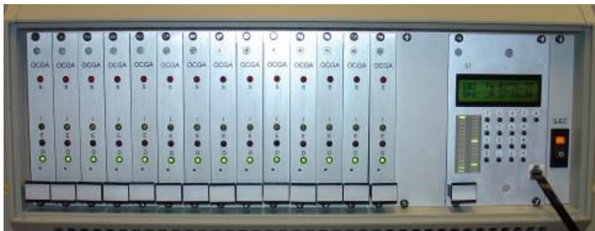
Rys. 12.6. Stacja odbiorcza z odbiornikami OCGA systemu ARAMIS M/E
