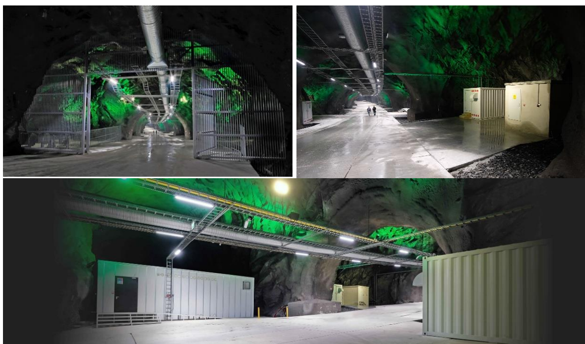
Rys. 13.15. Najbardziej energooszczędna serwerownia w Europie znajdująca się w norweskiej kopalni oliwinu Lefdal 150 m pod ziemią [Digital Report, 2022]
