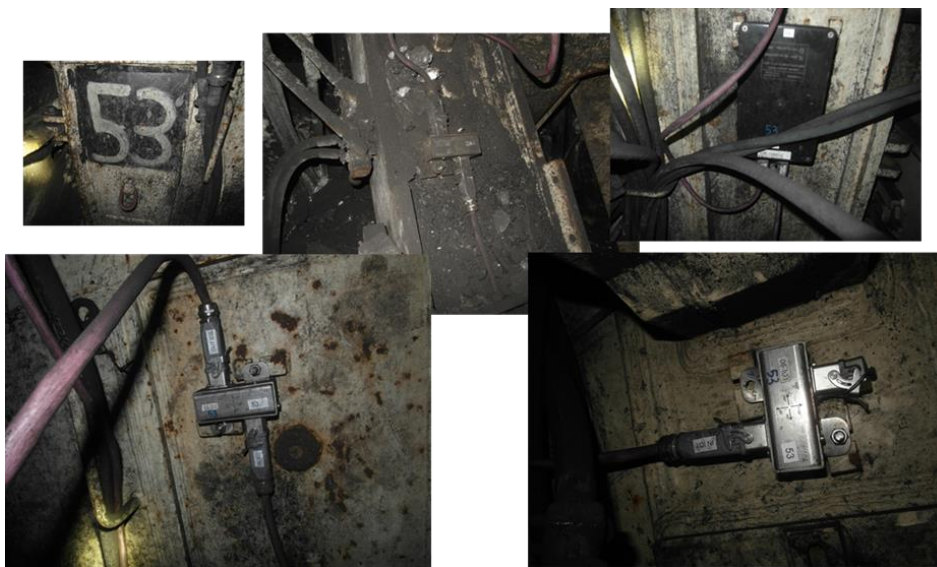
Rys. 9.37. Komponenty SSMS zainstalowane w ścianie CZ-2 KWK Budryk
