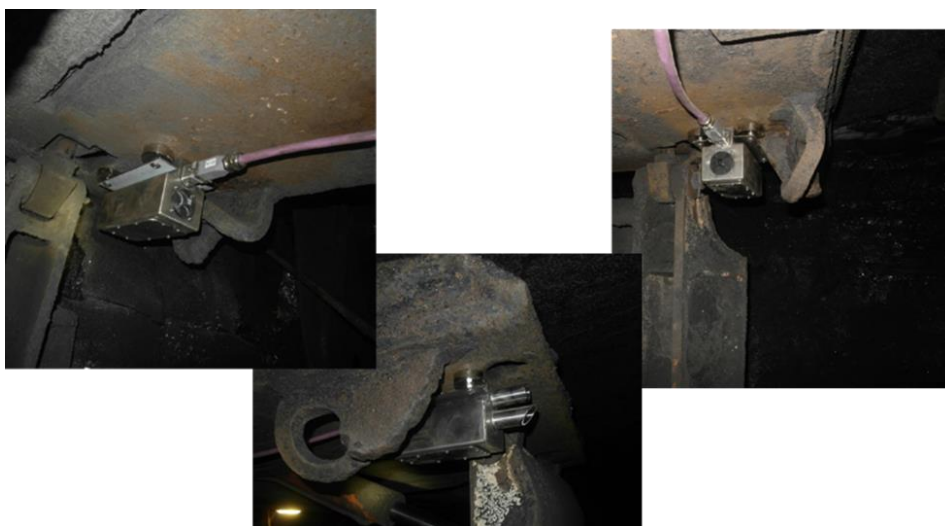
Rys. 9.34. Instalacja systemu SSMS w KWK Pniówek – SSMS-S
