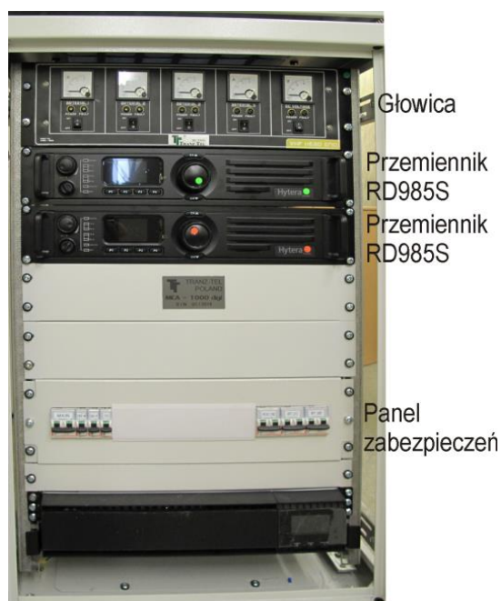
Rys. 5.36. Widok stacji bazowej systemu MCA1000digi firmy TRANZTEL
