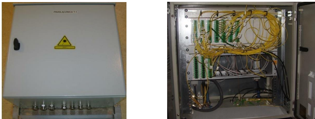
Rys. 6.34. Przełącznica światłowodowa T-1 firmy TIMLER: widok ogólny przełącznicy oraz jej wnętrza w jednej z kopalń
