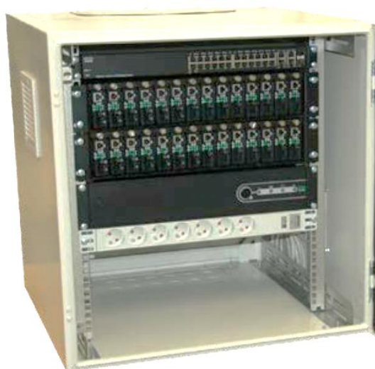
Rys. 6.33. Widok szafy konwertorowej Szk-3 firmy Carboautomatyka
