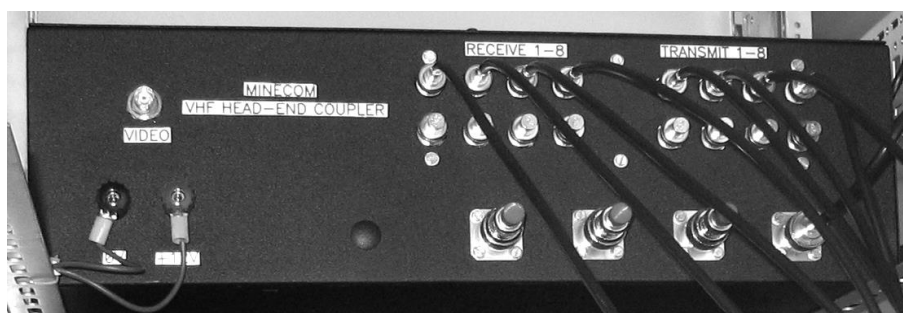
Rys. 5.31. Widok głowicy stacji bazowej z tyłu (system MCA 1000). Górne zaciski służą do podłączenia radiotelefonów (odbiorniczych i nadawczych), a zaciski u dołu do podłączenia czterech linii kabla promieniującego
