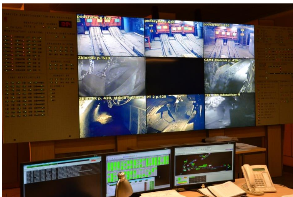
Rys. 6.40 d) Dyspozytornia zakładowa z ekranem wielkoformatowym przedstawiającym różne obrazy z kamer
