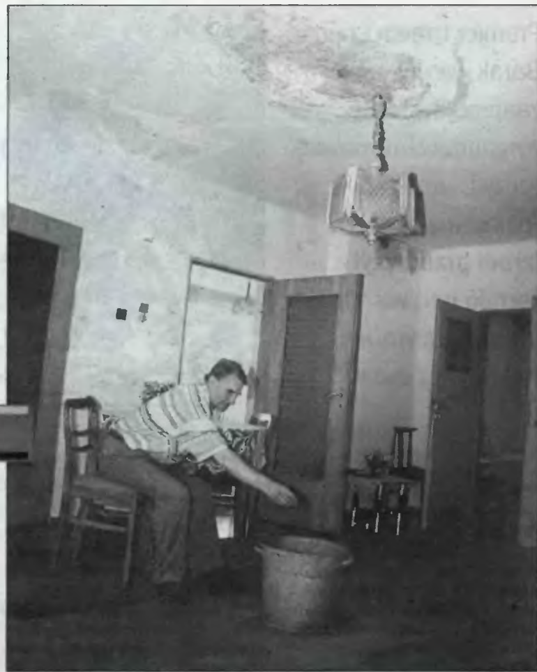
Dach w domu Andrzeja Jurczyka wyraźnie przecieka. Czy to efekt szkód górniczych?
