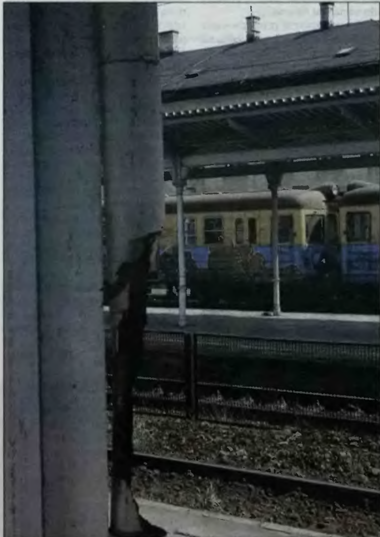
Czechowice-Dziedzice. Lepiej w czasie deszczu nie stać obok tak przerdzewiałej ryny.
