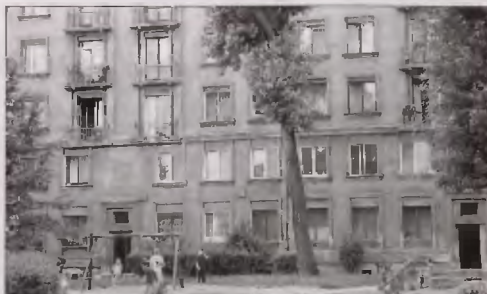
Wybudni komunalne w Węglowicach są stare, nie ocieplone. Długo oszczędne gospodarowanie ciepłem jest tu niemożliwe.
