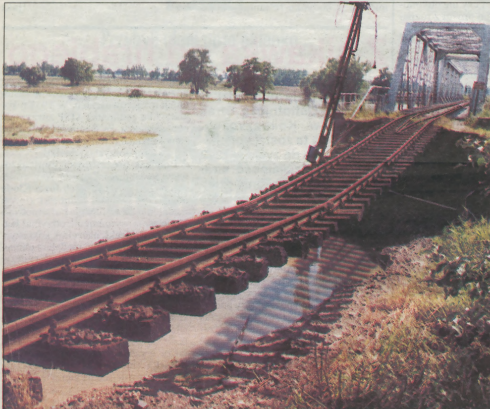
W Olzie po 50-metrowym kolejowym nasypie nie ma śladu.
