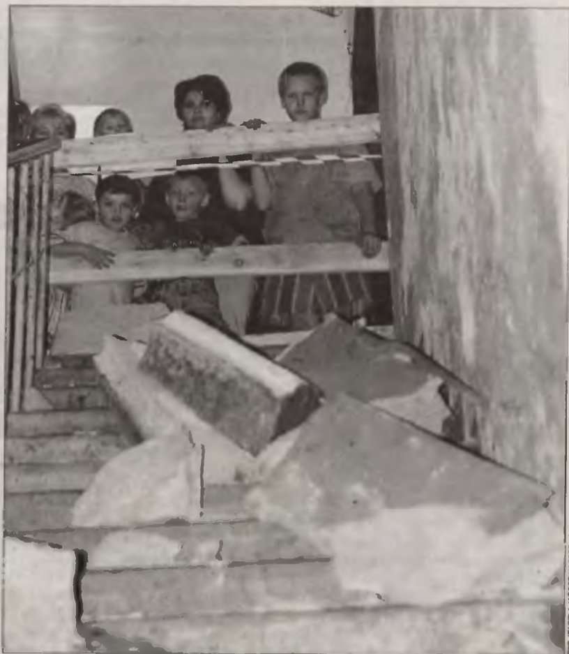
Betonowe schody runęły na parter z wysokości ok. 5 metrów. Dobrze, że dzieckom, które tu mieszkają nic się nie stało – podkreślają lokatorzy tej kamienicy.
