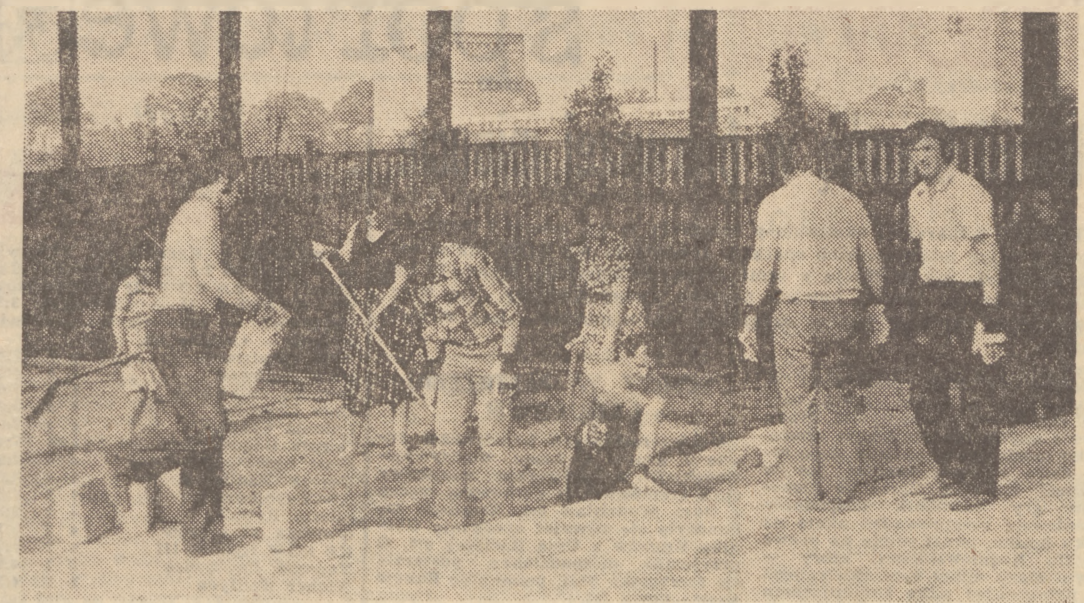
Młodzi z PRG nie boją się żadnej pracy. Na zdjęciu: układanie nawierzchni pod wiatą bazy. Zdjęcie: M. SOBIEK
