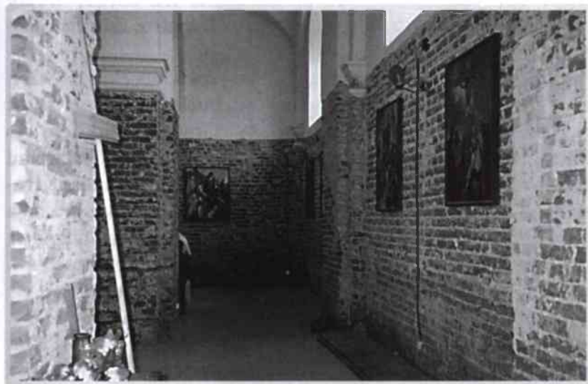
11. Zniszczone ściany kościoła w Zaturcach. Fot. ze zbiorów autora
