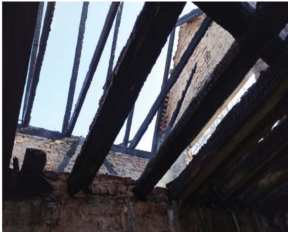
Budynek wymaga generalnego remontu
