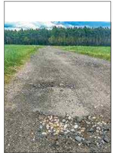
Droga na Opaleniec wymaga napraw
