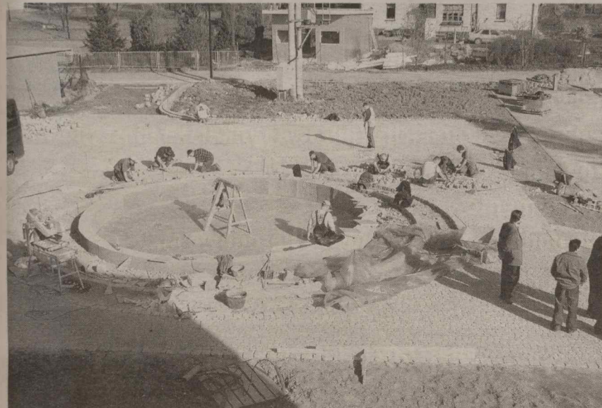
W przerwie obrad radni poszli obejrzeć, jak przebiegają prace na placu przed urzędem gminy.
