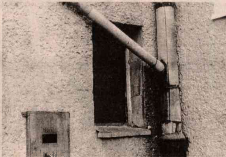
Administracja budynku zabezpieczyła jedynie okna do zsypu
