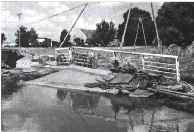
Most został zniszczony i dojazd z miejscowości Bielice i Jasienica Dolna stał się niemożliwy
