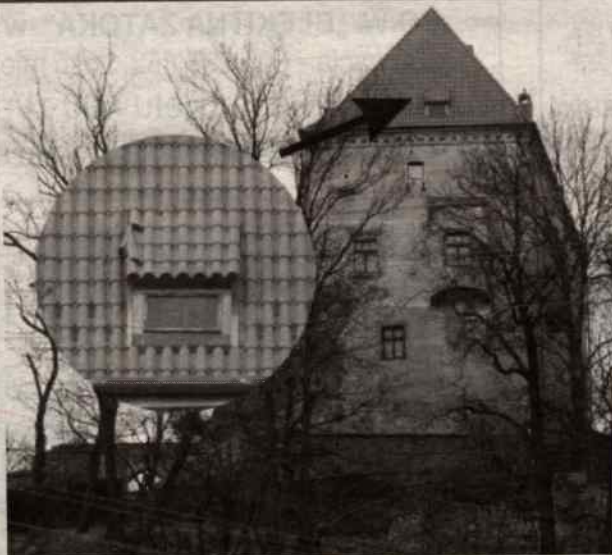
Dachówki jednego z zamkowych okienek są mocno obluźnione, co jest doskonale widoczne
