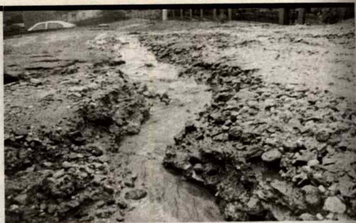
Ulewny deszcz wyłobził koleiny utrudniające dojazd do domów
