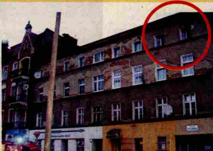
Pożar wybuchł na ostatnim piętrze i mógł strawić drewnianą konstrukcję całego budynku
