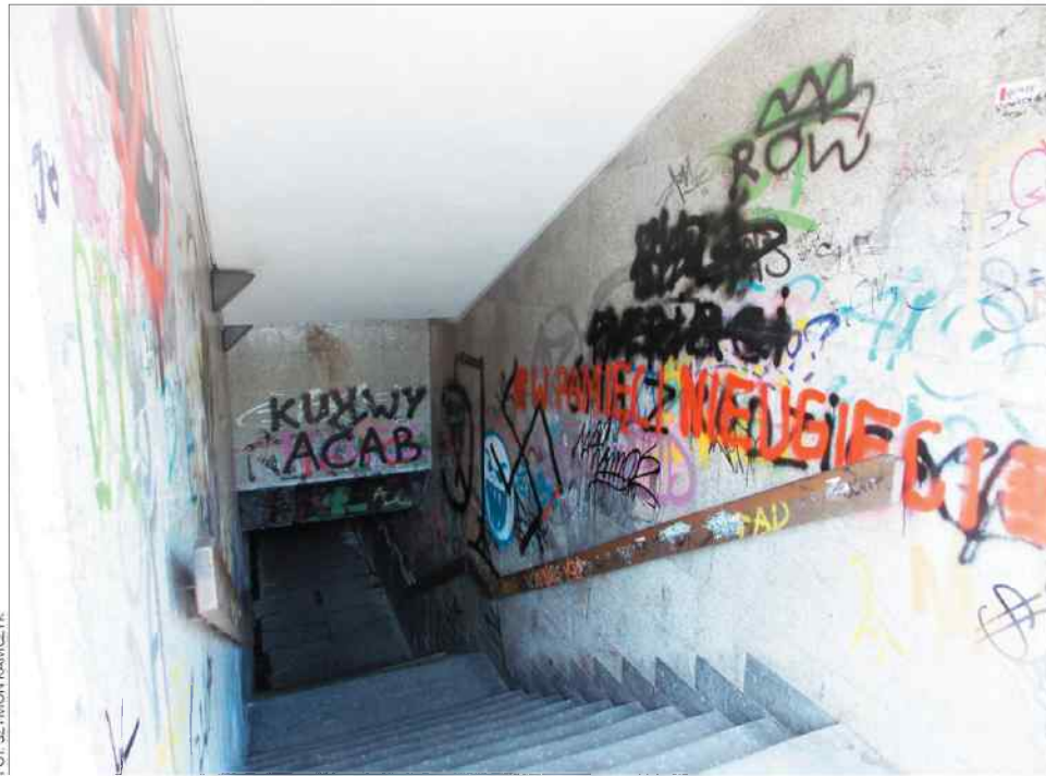
Ściany tunelu pokryte są graffiti. Posadzka nadaje się do wyrównania, a żarówki do wymiany. Remont przejścia zaplanowano na lata 2016-2017.
