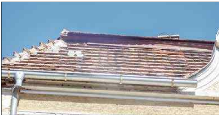
Na dachu PCPR widać, że brakuje kilku dachówek
