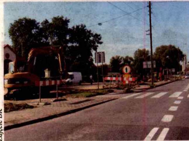
Zdjęcie BK Prace przy budowie ronda w Praszce na razie są prowadzone poza pasem drogowym. Utrudnienia pojawią się we wrześniu.
