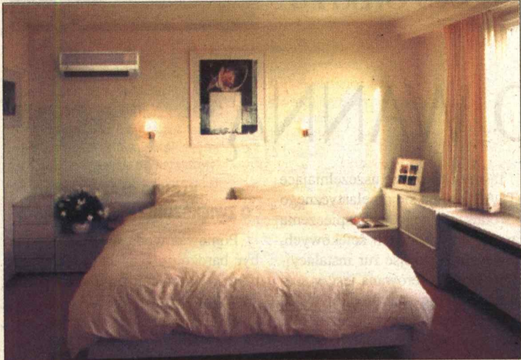
W klimatyzowanej sypialni śpi się przyjemnie nawet podczas największych upałów. Klimatyzator typu split składa się z jednostki wewnętrznej (tu wisi na ścianie) i zewnętrznej umieszczonej na zewnątrz domu
