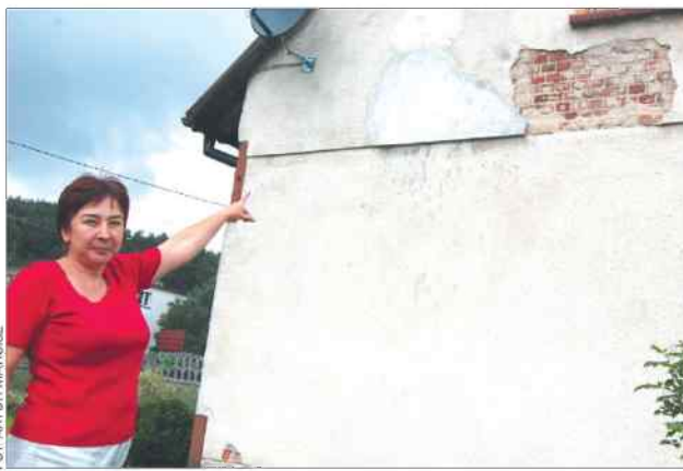
Krystyna Sobik nie ma wątpliwości, że odpadający tynk to efekt ciężarówek co chwilę mknących przed jej domem
