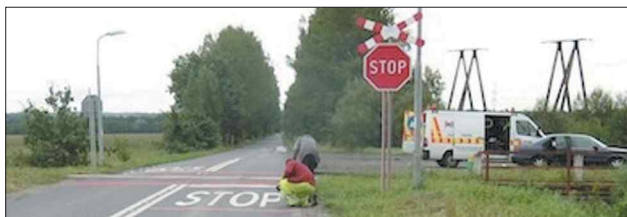
Oznakowanie wymieniono także przy niestrzeżonym przejeździe na drodze wojewódzkiej w Bukowie
