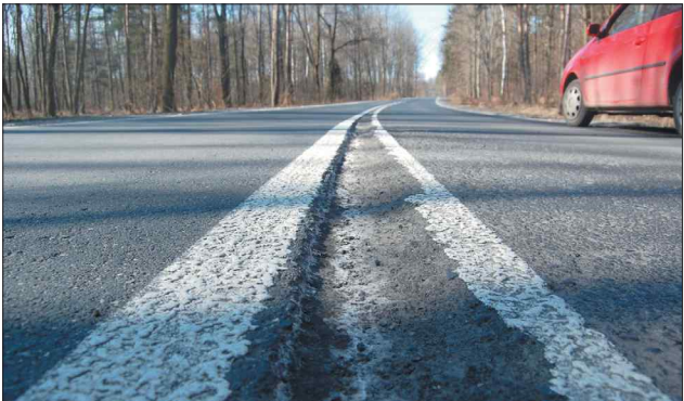
Na kilku odcinkach nowej drogi na ulicy Rogowskiej jej środkiem przebiega pokaźne „korytko”. Droga wymaga więc już naprawy.
