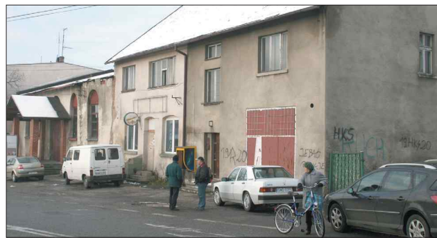
Zabite okna, zaplombowane drzwi, niszcząca elewacja – widok od lat ten sam
