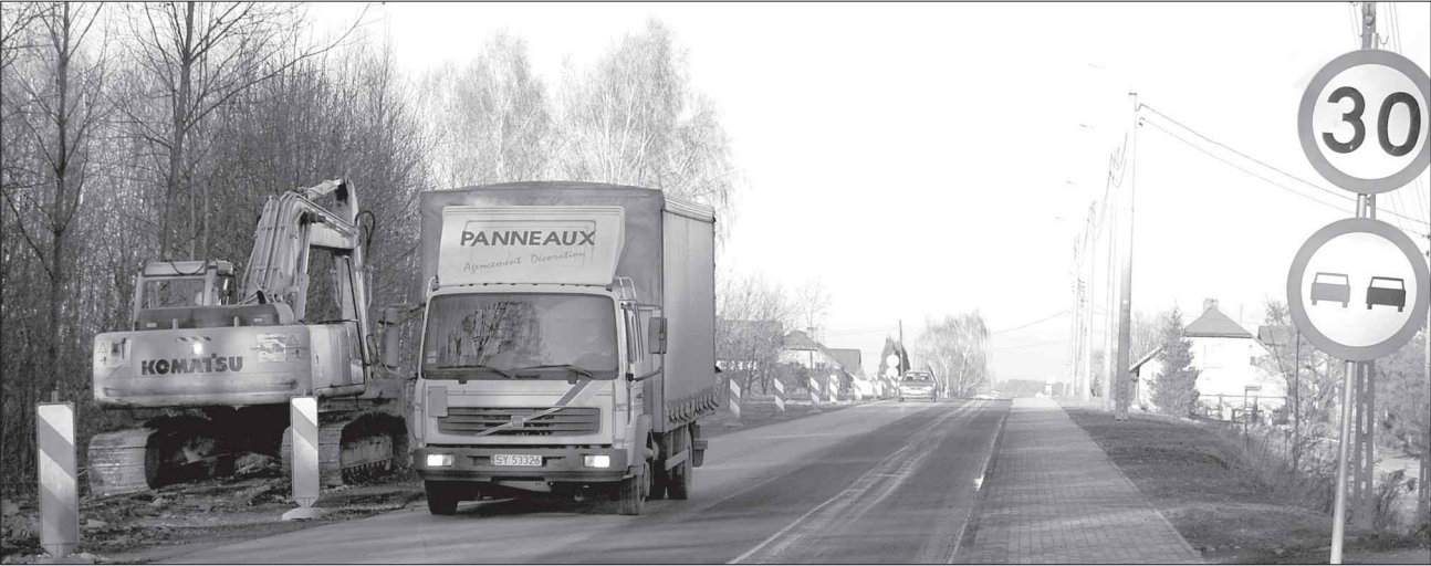
Po wiadukcie w Skrzyszowie nie ma już śladu, a ulica 1 Maja jest w tym miejscu przejezdna od kilku dni
