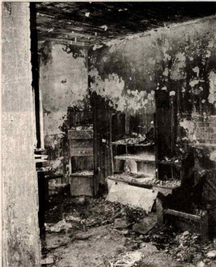
Mieszkanie zostało doszczętnie spalone. Pożar mógł doprowadzić do ogromnej tragedii
