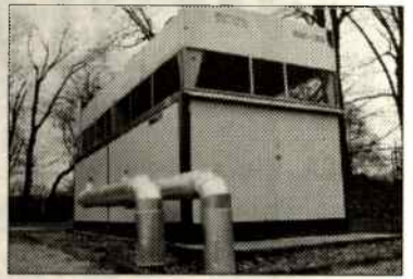
Agregat do chłodzenia MAC 360 wyprodukowany przez Mostostal Wrocław, którego oferta wygrała w przetargu
