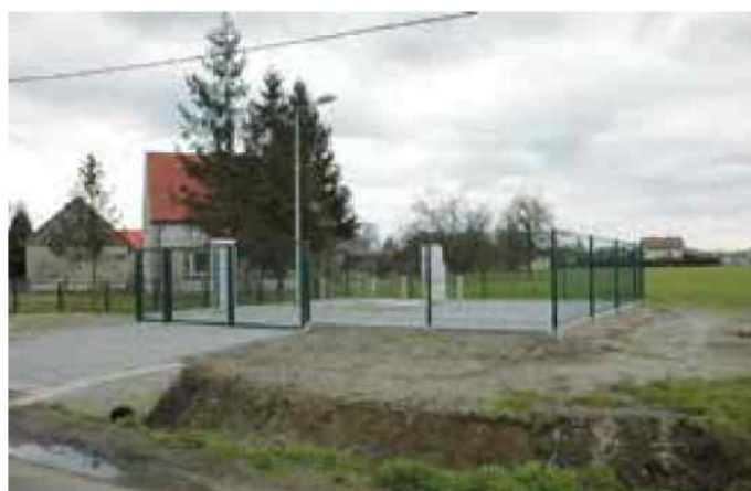
Przepompownia ścieków w Dziergowicach
