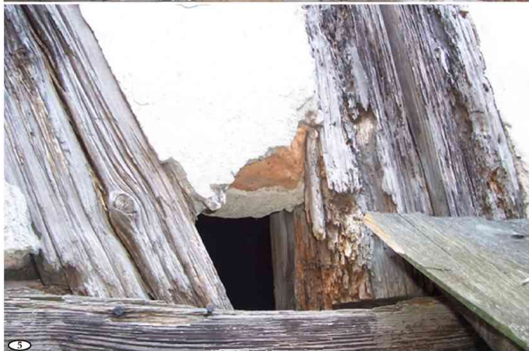
Ryc. 4. Istniejące stalowe ściągi mające wzmocnić konstrukcję wieży Ryc. 5. Zniszczone elementy nośne ścian tworzącej kosz rynnowy
