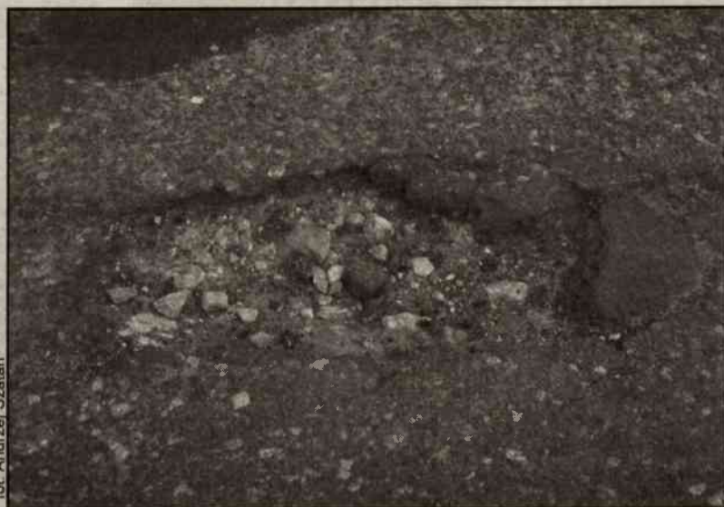
Ta głęboka dziura jest na środku głównej ulicy Kowali (gm. Praszka). Trzeba jakiegoś nieszczęścia aby ją zasypać?
