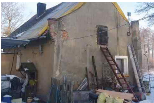
Dom, w szczególności dach, wymaga szybkiego remontu.
