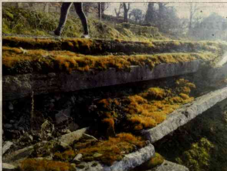
Fragment obsuwającej się drogi
