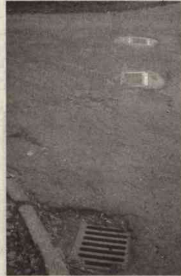
Trzy studzienki na drodze dojazdowej do mieszalni pasz w Baborowie nie spełniają swojego zadania i są jedną z przyczyn zalewania drogi pod wiaduktem
