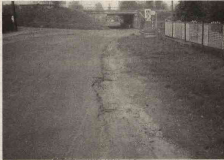
Wzdłuż drogi przy ulicy Opawskiej woda wydrążyła rów i podmyła asfalt
