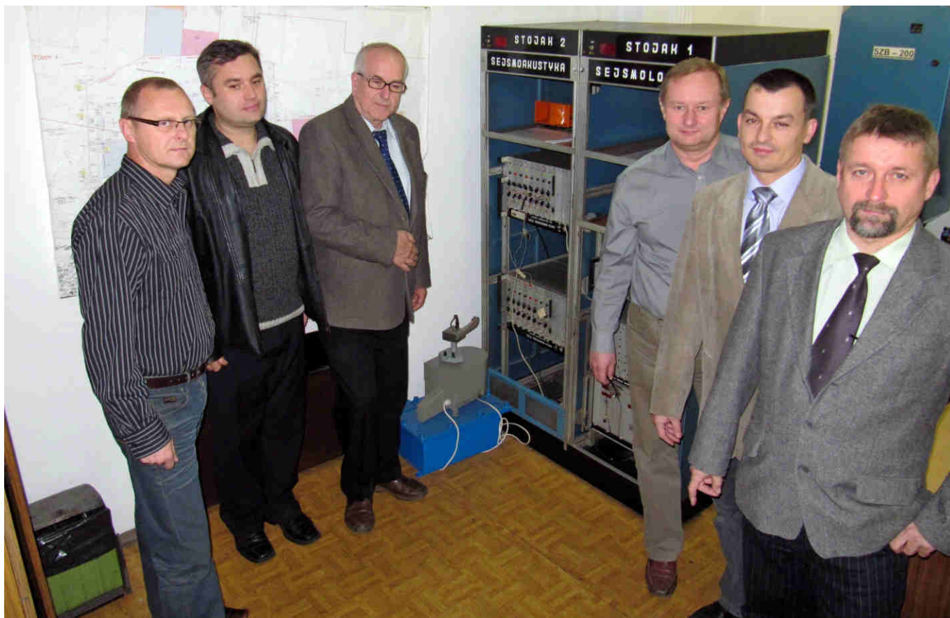
Dozór kopalnianej stacji sejsmologicznej. Stoją od lewej: Jarosław Franiczek, Damian Grychnik, Tadeusz Kabza, Piotr Ostrzolek, Piotr Kaleta, Zbigniew Szurman.
