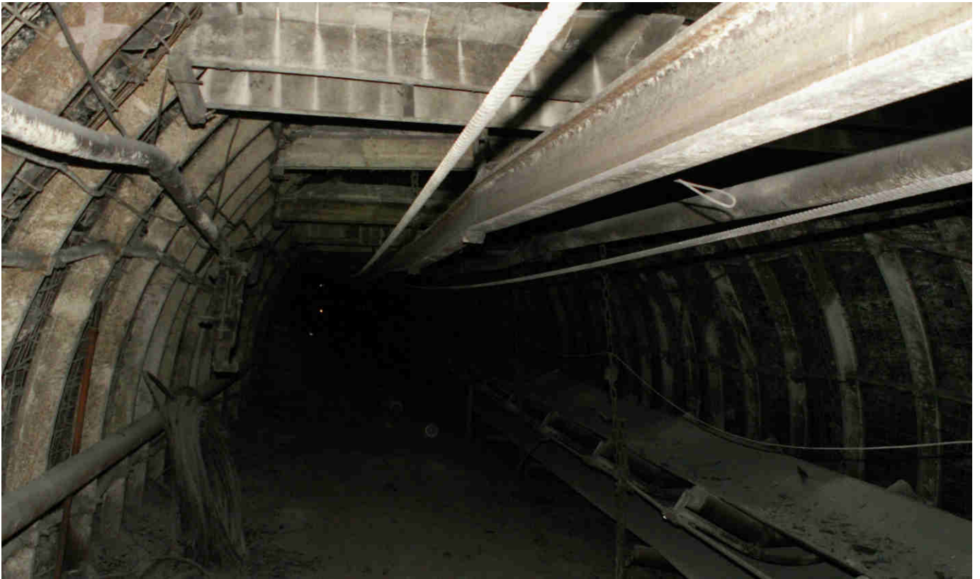
Zapora pyłowa na trasie odstawy ścianowej.
