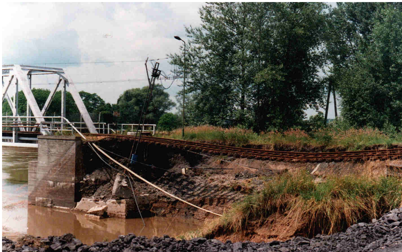
Zniszczeniu uległy również most i tory kolejowe w Olzie.
