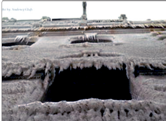
Złodowacenia po pożarze fot. Andrzej Głąb
