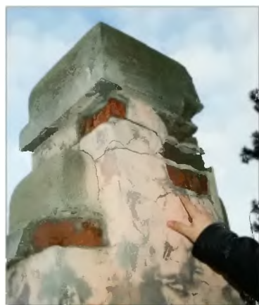
Niektóre części ogrodzenia rozpadają się
