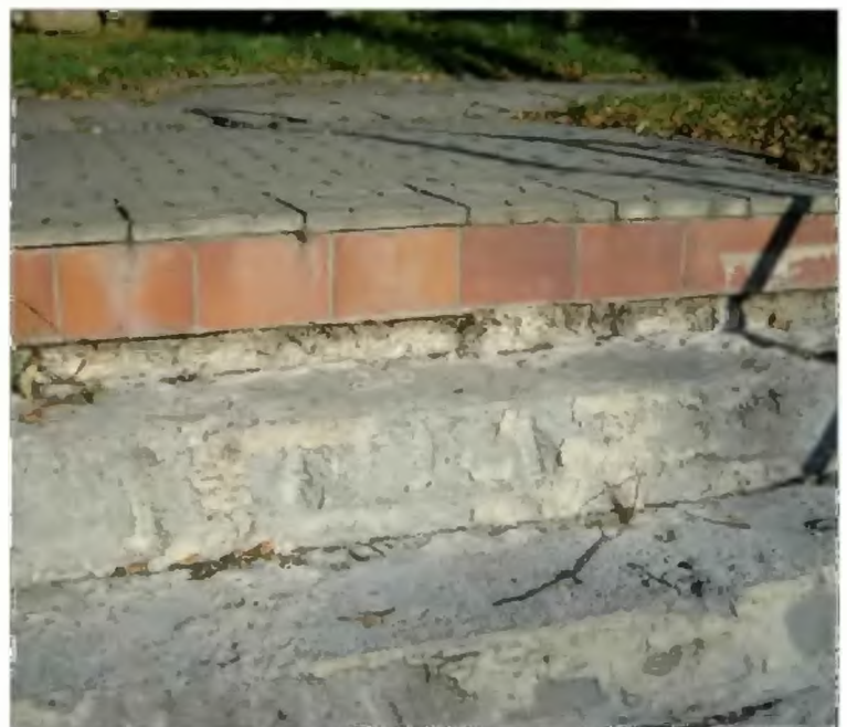
Zniszczone schody przy dworcu autobusowym w Głogówku
