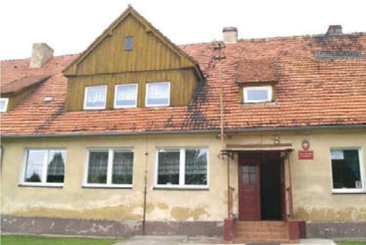
Gołym okiem widać, że Szkoła Podstawowa w Makowicach wymaga remontu
