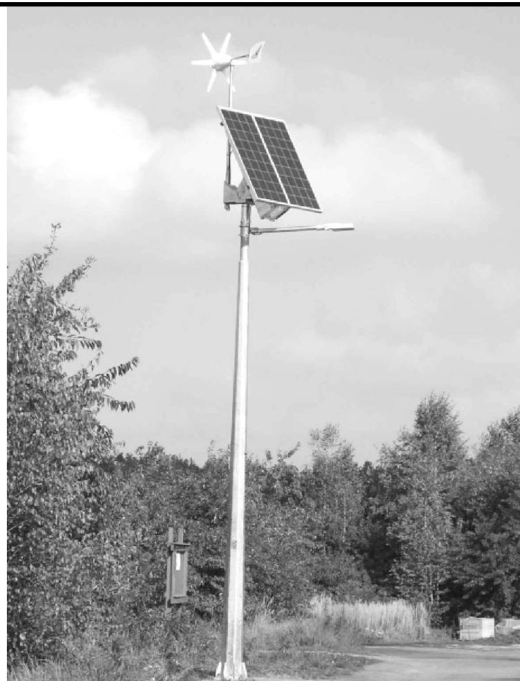
Na ulicy Kasztanowej w Skorochowie stanęły trzy latarnie hybrydowe. Czy spełnią swoje zadanie, okaże się wiosną.
