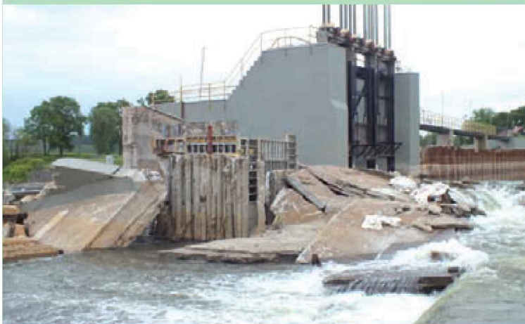
Obraz zniszczeń jazu może budzić grozę
