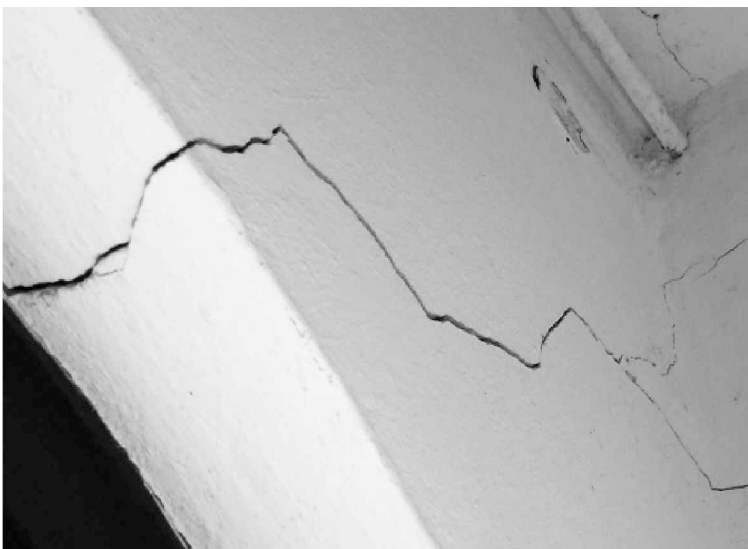
Pęknięte mury jednego z budynków klasztoru, zdaniem jego mieszkańców, to efekt działalności kopalni
