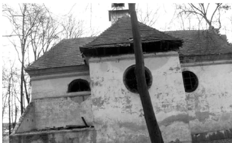
Katolicki kościół popada w ruinę, gdyż od kilkadziesiąt lat nie był remontowany
