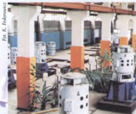
Stacja Uzdatniania Wody w Goczałkowicach
