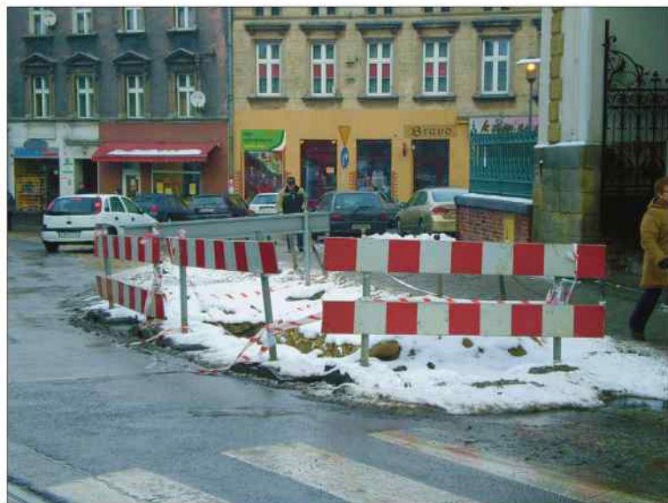
Awarie były spowodowane robotami m.in. na ul. Bytomskiej
