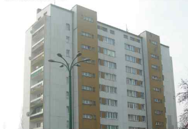
Wspólnoty mieszkaniowe na Osiedlu Stałym przy ulicy Starowiejskiej 1-3 oraz Starowiejskiej 5-7, które wcześniej „straszyły” uszkodzonymi elewacjami z acekolu...
