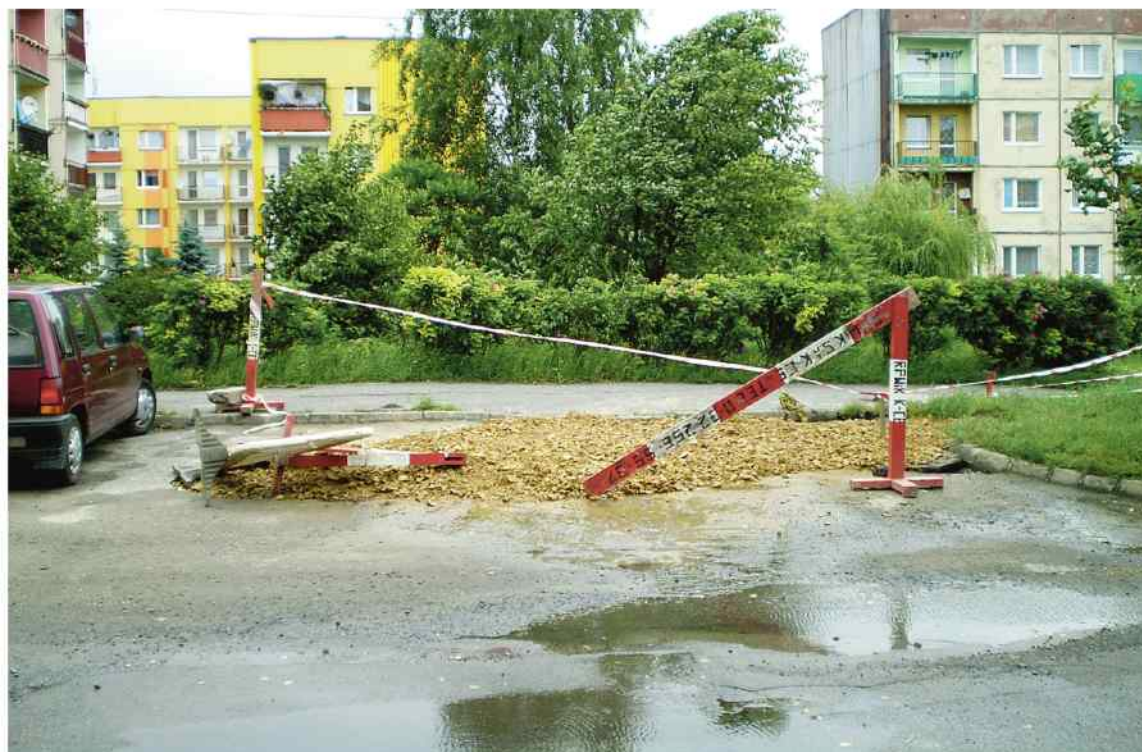
Wczoraj pracownicy RPWiK mieli zlokalizować jeszcze jeden wyciek na ul. Nowowiejskiego
