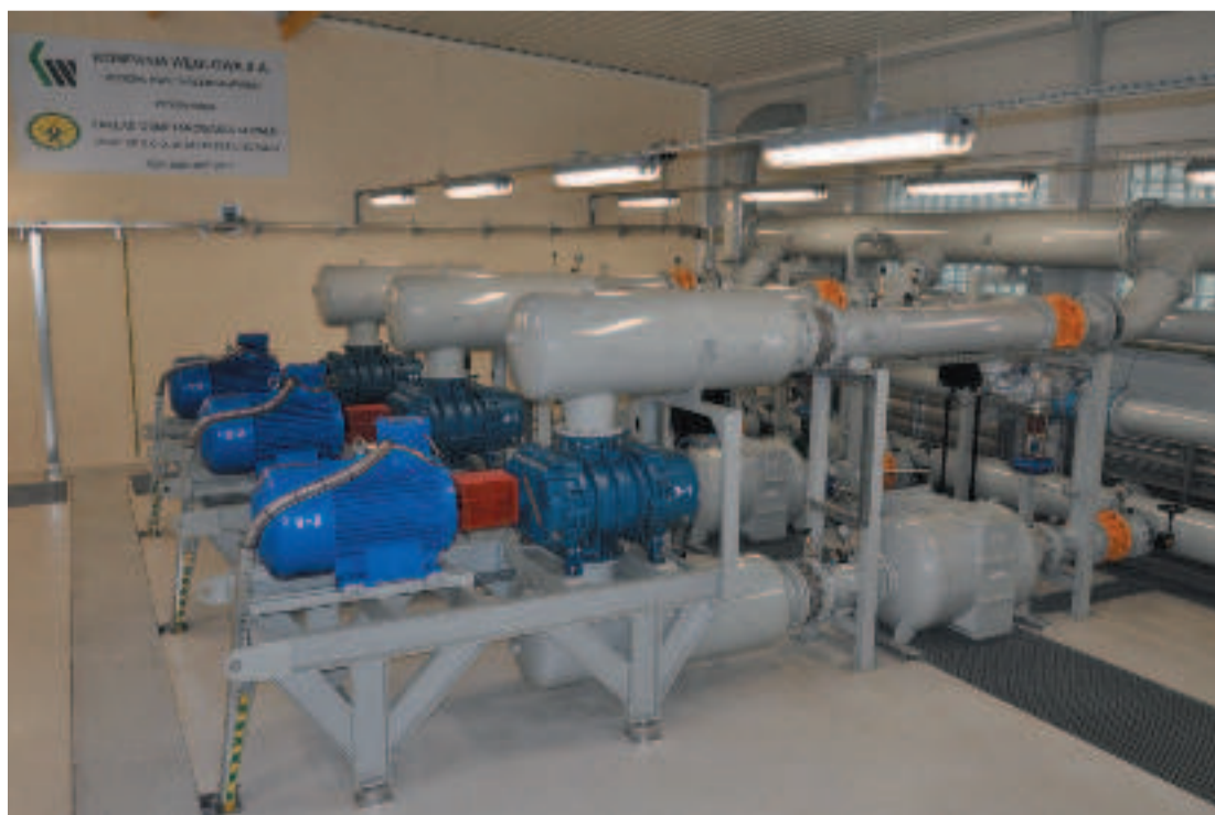
Nowowbudowana stacja odmetanowania w KWK „Halemba-Wirek”.
