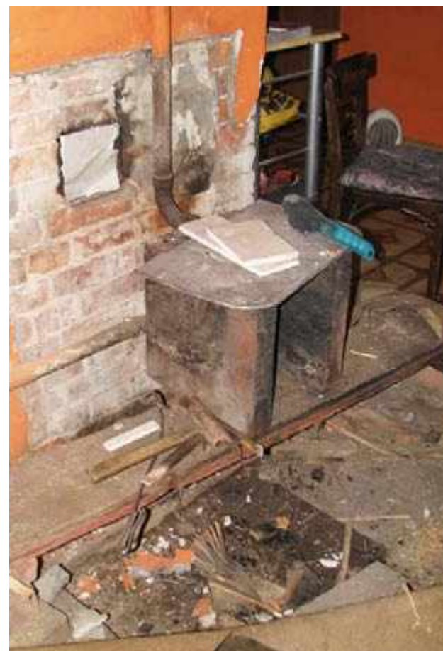
W domu wybuchł pożar, w wyniku którego spalił się piec i podłoga pod nim.
