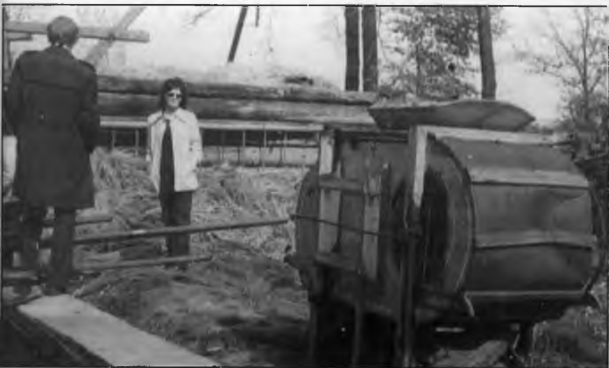
Kryry - rozbiórka 8-bocznej stodoły u Waleczka (1974 r.). Na pierwszym planie ręczny „fachel”.
