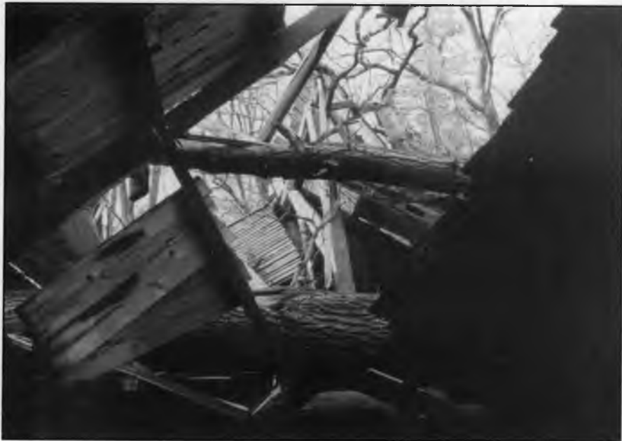
Tak wyglądał dach wozowni, zawalony pod ciężarem mokrego śniegu.
