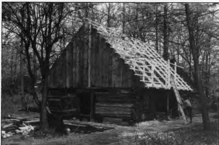
Montaż dachu wozowni z Miedznej po katastrofie budowlanej w skansenie wykonany przez cieśli-górali ze Stryzawy pod kierunkiem P. Wróbla.
