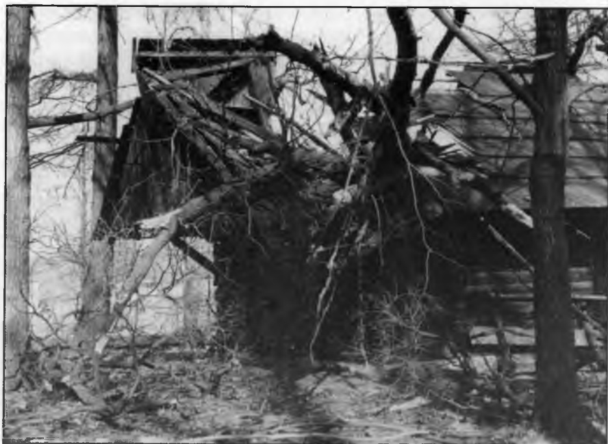
Kuźnia po zwałeniu się na nią starego dębu i zniszczeniu dachu w 1974 roku.
