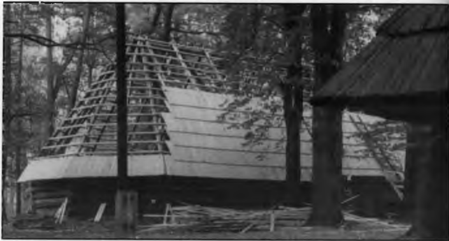
Stodoła z Kryr. Widoczne wadliwe krycie dachu. Podwójne krycie gontem polega bowiem na tym, że 3 rząd gontów dotyka górnej krawędzi 1 rzędu. Dach czasem przecieka.
