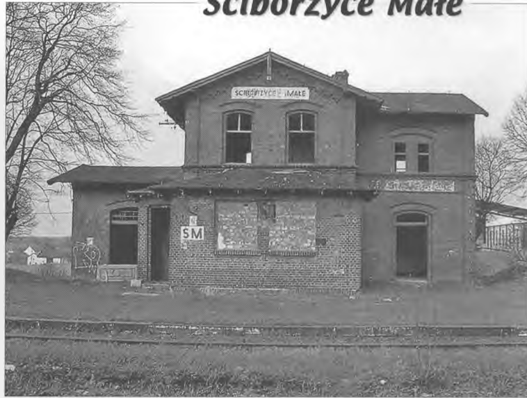
Piękny niegdyś budynek dworca w Ściborzycach Małych dziś dosłownie ginie na naszych oczach. 22.04.2005 r. fot. Piotr Kopczyk
