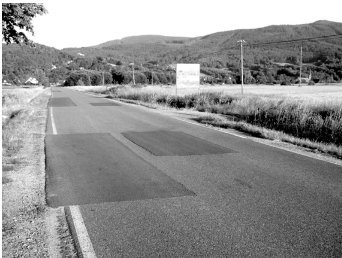
Po naprawach w ramach gwarancji, nawierzchnia trasy Konradowa - Jarnołtówek pokryta jest łatami a jazda po drodze powiatowej przypomina odcinek testujący zawieszenie samochodu
